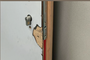
Zimmertüre mit Schaden
