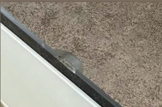
Keramikplatte mit Abplatzung
